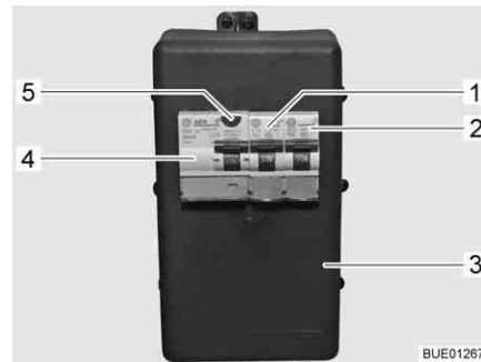
Fig. 169 Scatola dei fusibili a 230 V con interruttore di sicurezza e interruttore automatico FI
