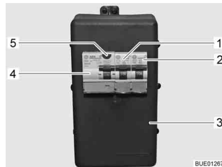
Fig. 156 Scatola dei fusibili a 230 V con interruttore di sicurezza e interruttore automatico FI
