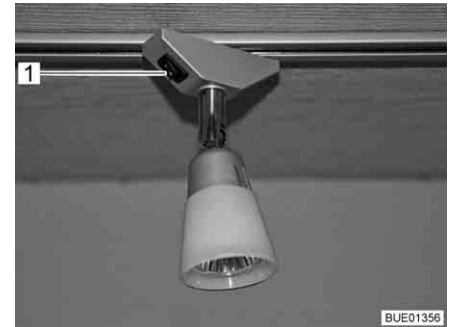
Fig. 53 Faretto alogeno, interruttori luci in corrispondenza della lampada
