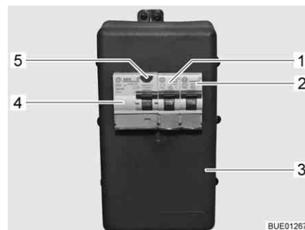
Fig. 177 Scatola dei fusibili a 230 V con interruttore di sicurezza e interruttore automatico FI
