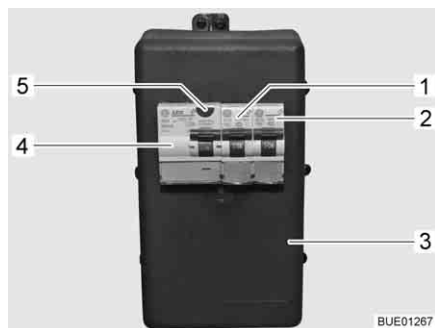
Fig. 167 Scatola dei fusibili a 230 V con interruttore di sicurezza e interruttore automatico FI
