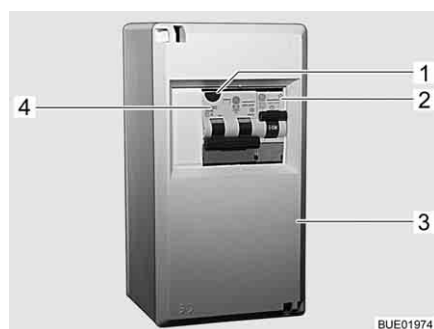
Fig. 179 Scatola dei fusibili a 230 V
